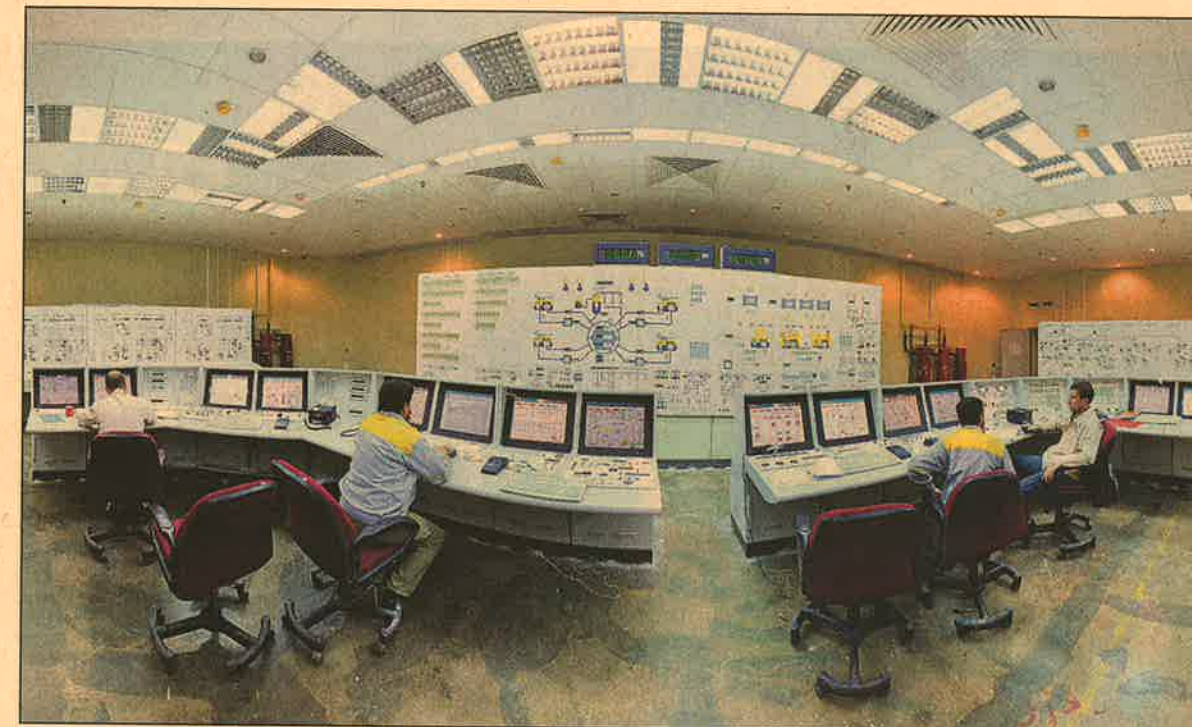
So ruhig wie auf dem Foto geht es im Kontrollraum des iranischen Atomkraftwerks Bushehr derzeit sicherlich nicht zu. Computerwurm Stuxnet hat auch hier Rechner befallen. Foto: AP / Mehdi Ghasemi
